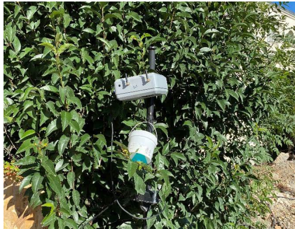
Station de surveillance PID et particules fines
